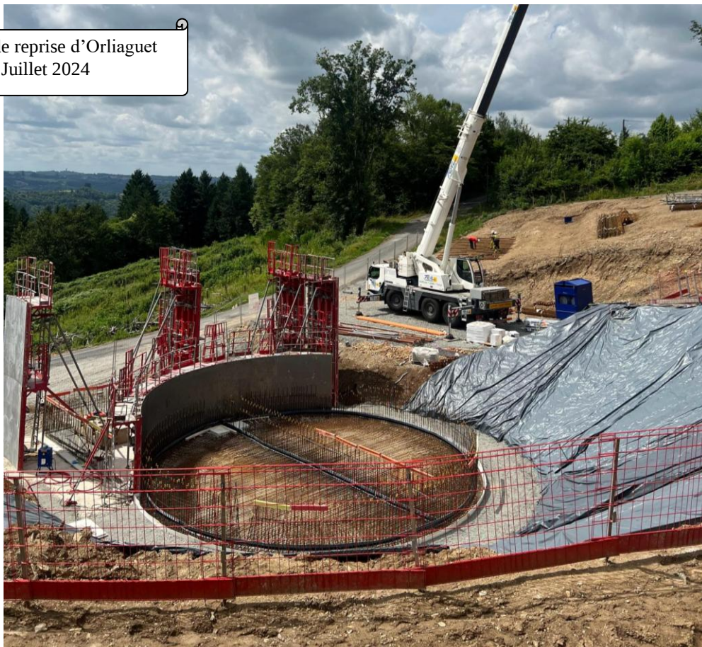
Station de reprise d'Orliaguet Novembre 2024
